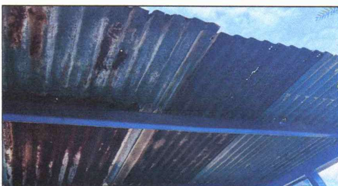
Foto 4: Láminas de galera de pileta en mal estado.
