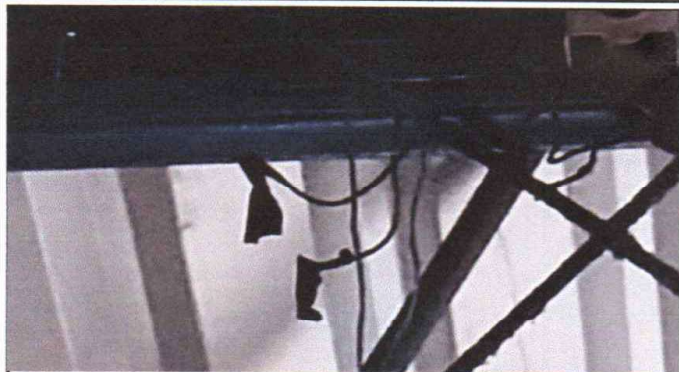
Foto 1: Cables eléctricos del salón de usos múltiples en malas condiciones.
