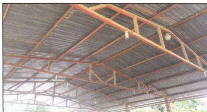
Foto 5: Láminas del Polideportivo en malas condiciones.
