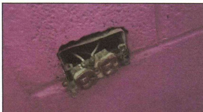
Foto 3: Sistema eléctrico de aulas en malas condiciones.
