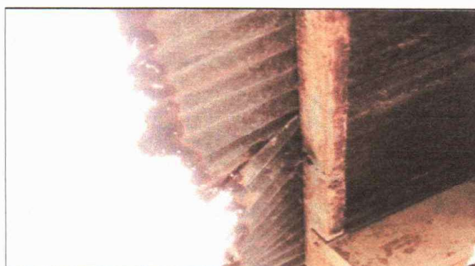
Foto 4: Láminas del Nivel Primario en deterioro.
