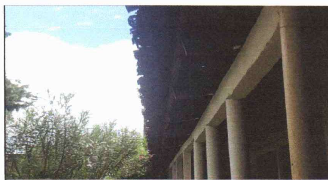
Foto 6: Láminas de aulas en deterioro.
