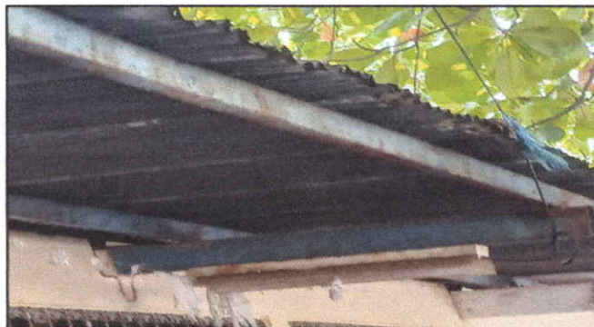
Foto 4: Lámina de un aula en estado de corrosión y desgaste.
