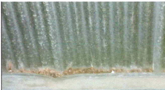
Foto 3: Láminas y costaneras presentan un deterioro significativo.
