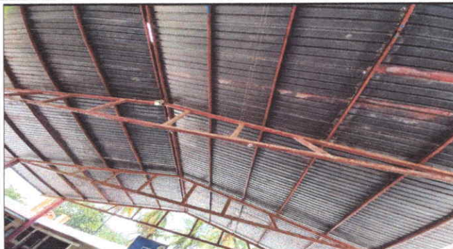
Foto 2: Láminas y estructura metálica del polideportivo en deterioro.
