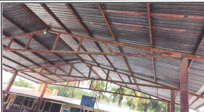
Foto 1: Láminas y estructura metálica del Polideportivo en malas condiciones.
