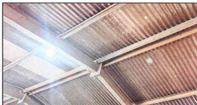
Foto 6: Láminas en malas condiciones.
