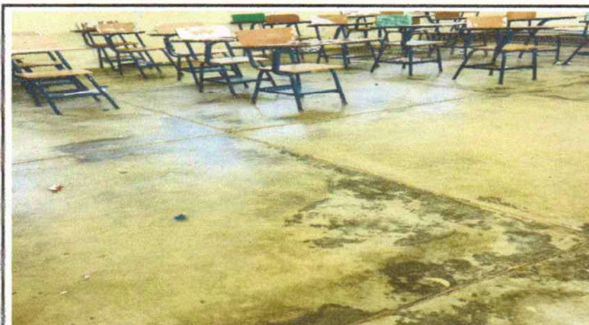
SUSTITUCION DE PISO LIQUIDO DE CEMENTO EN MODULOS DE AULAS POR CERAMICO
