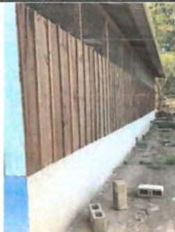
Foto 5: pintura en mal estado y parte sin pintar
