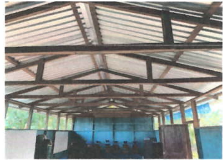
Foto 4: soporte de madera en mal estado
