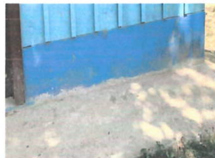
Foto 6: banqueta en mal estado
