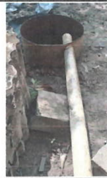
foto 10: fosa septica en mal estado
