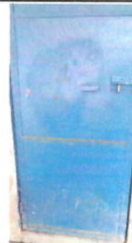
Foto 2: puerta de baño en mal estado
