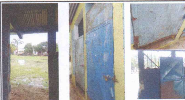
Foto 1: PUERTAS: Puertas deterioradas tanto de aulas como de sanitarios.
