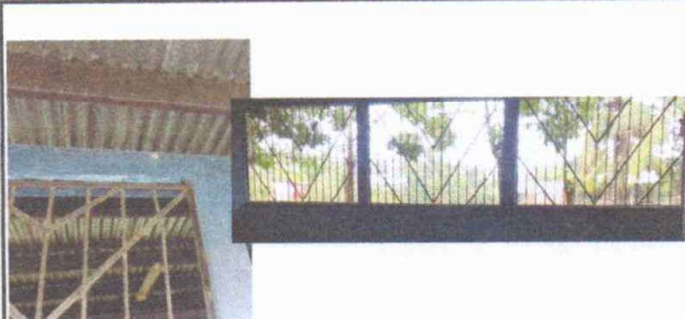
Foto 2: VENTANAS: Requieren mantenimiento y remodelación ya que se encuentran deterioradas y en malas condiciones.
