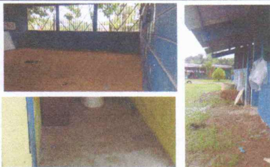
Foto 3: PISOS: Reparación de pisos torta de cemento por Piso Cerámico ya que el existente está agrietado y se filtra la humedad.
