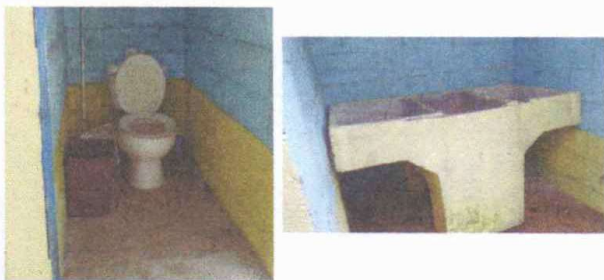
Foto 5: LOZA SANITARIA: Se encuentran en mal estado, necesitan lavamanos adecuados para uso sanitario.
