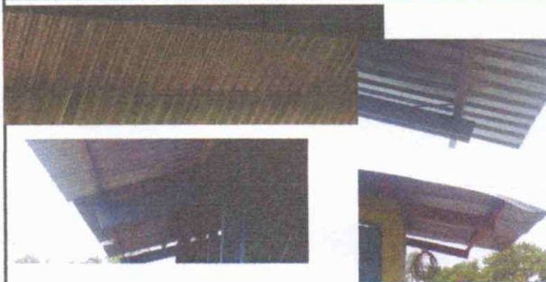
Foto 4: TECHO DE LAMINA: Reparación del techo, ya que se encuentra en mal estado, se filtra el agua cuando llueve, algunas láminas están dañadas.
