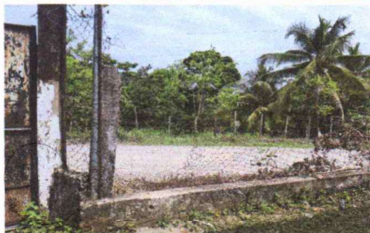
Foto 3: REMOZAMIENTO DE MALLA QUE SE ENCUENTRA CON OXIDO Y EN MAL ESTADO
