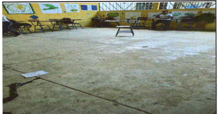
Foto 4: Instalacion de piso en mal estado
