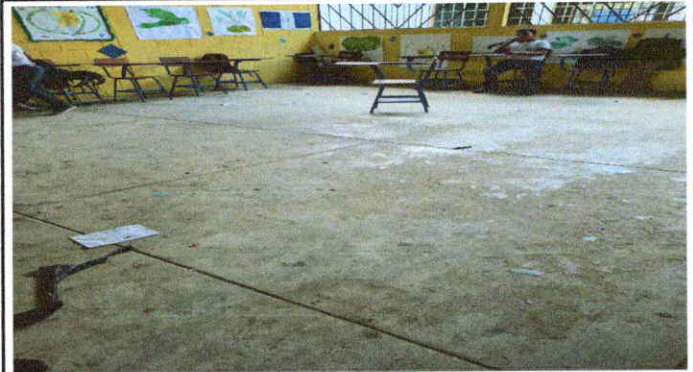
Foto 2: Instalacion de piso en mal estado
