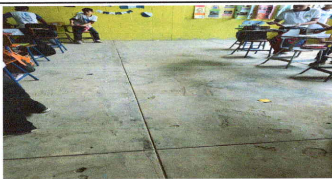
Foto 3: Instalacion de piso en mal estado
