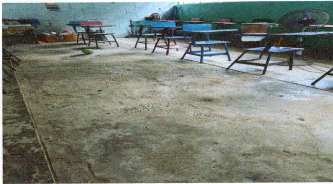
Foto1: Instalacion de piso en mal estado
