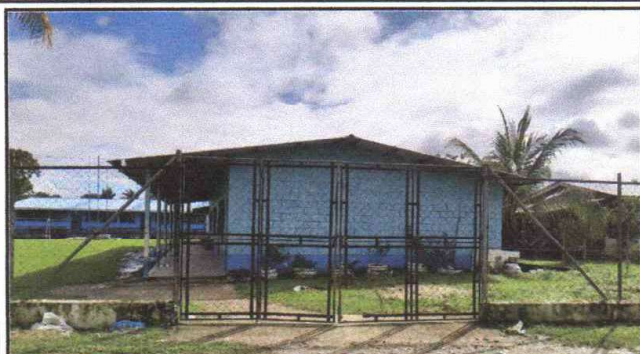
Foto 1: Reparación de portón, ya que se encuentra en mal estado
