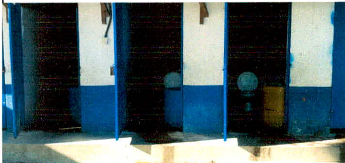
FOTO NO.7 Drenajes de sanitarios alumnos en mal estado.
