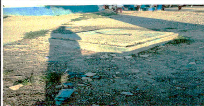
FOTO NO.4 Drenajes en mal estado, se llena la escuela cuando llueve.
