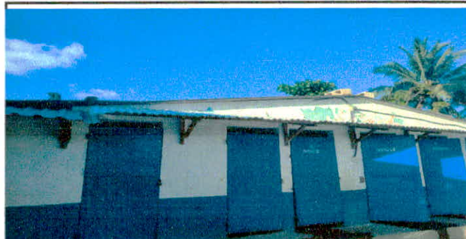
FOTO NO.2 Techo sobre los sanitarios de los estudiantes en mal estado
