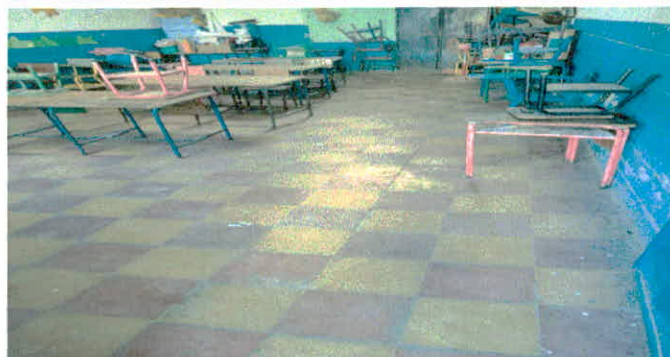
FOTO NO.3 Piso de aula de preprimaria en mal estado, se inunda cuando llueve.
