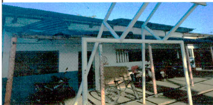
FOTO NO.1 Galera en mal estado, estructura y techo.
