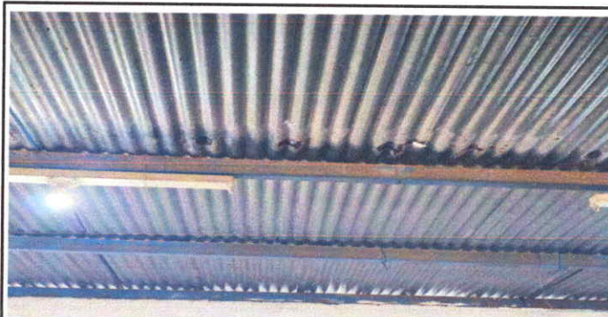
Foto 5: Techo en mal estado.
