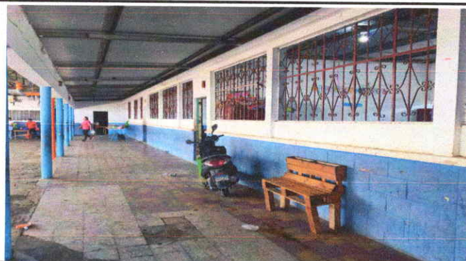
Foto 3: Pintura en mal estado.
