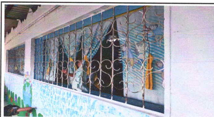
Foto 4: Pintura en mal estado.
