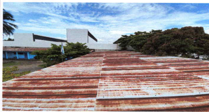
Foto1: Lamina en mal estado
