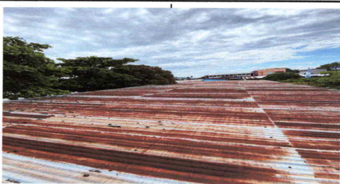
Foto 3: Lamina mal estado.
