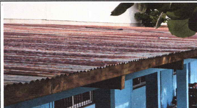
Foto 2: Techo en mal estado
