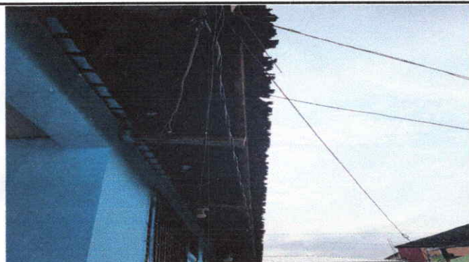
Foto1: Techo en mal estado
