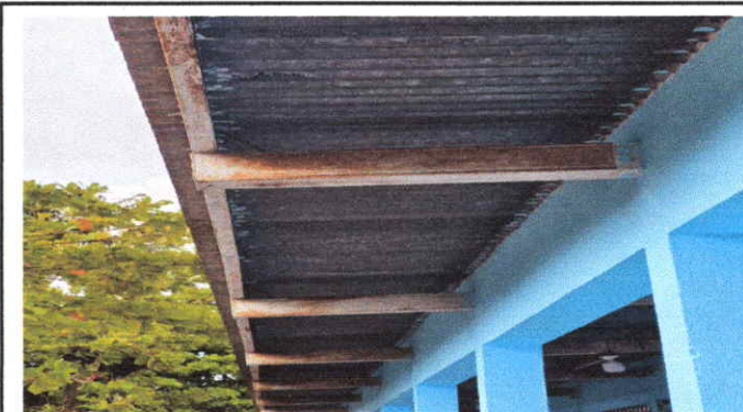
Foto 4: Techo mal estado
