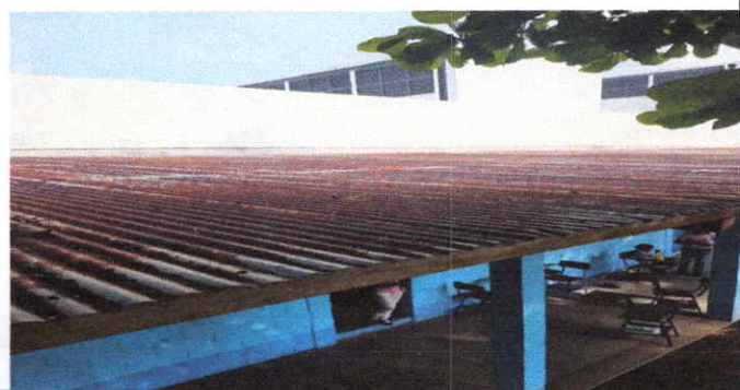
Foto 3: Techo en mal estado
