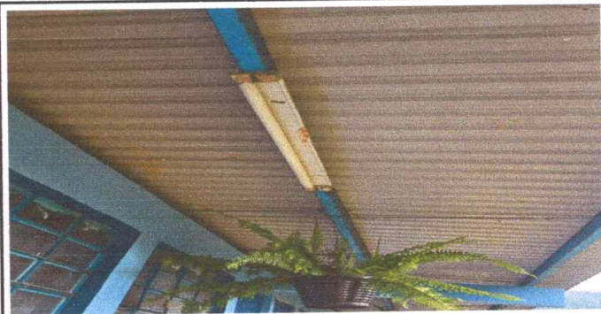
Foto No. 6: Lamparas en mal estado
