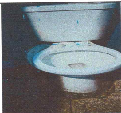
Foto No. 5: Sanitarios en mal estado
