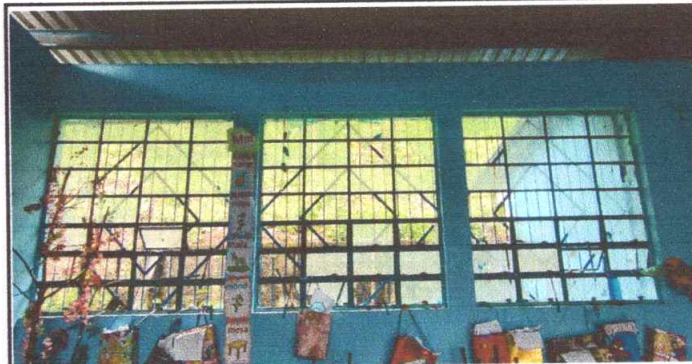
Foto No 4: Vidrios de ventanas en mal estado.
