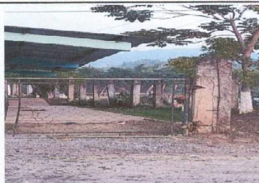
Foto 4: Portón en mal estado
