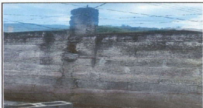
Foto No 11: Muro perimetral en mal estado.
