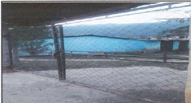
Foto No. 9: Portón en mal estado.
