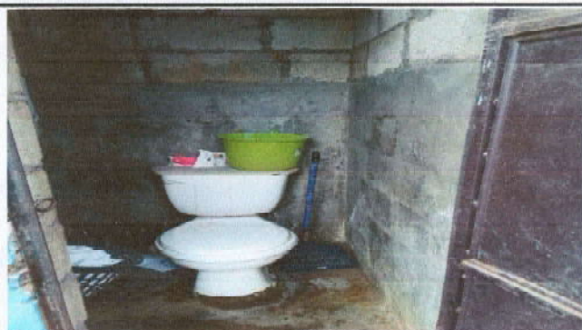
Foto No 8: Sanitarios en mal estado.
