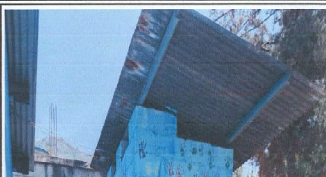
Foto 2: Estructura de techo en mal estado
