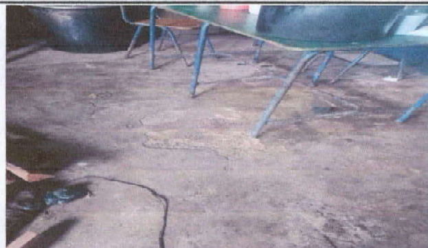
Foto No 6: Piso de cocina en mal estado.
