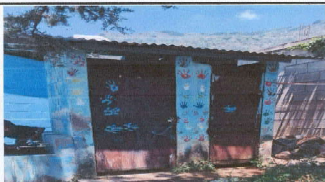
Foto 3: Puertas de sanitarios en mal estado.
