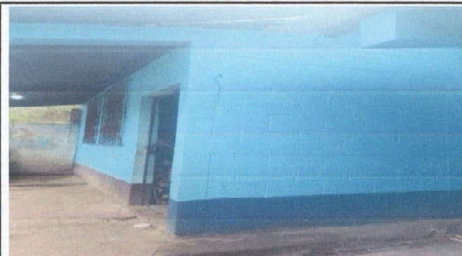
Foto No 7: Pintura de muros incompletas.
