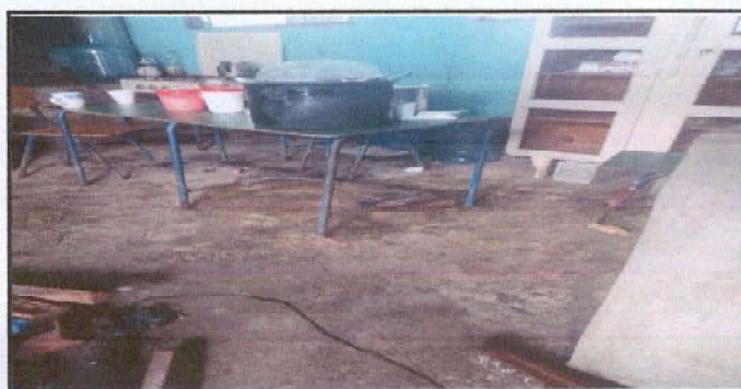
Foto No 10: Cocina en mal estado.
