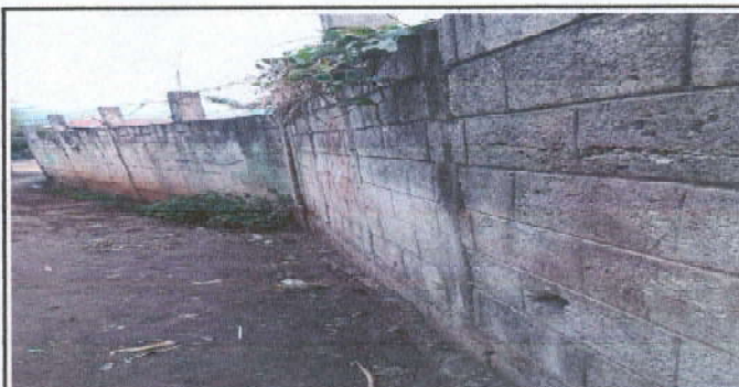
Foto 6: Muro perimetral en mal estado
