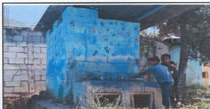
Foto 5: Pintura en mal estado
