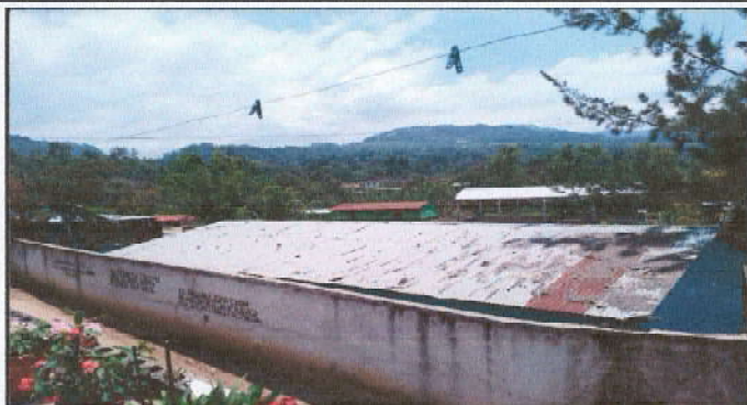
Foto 1: Cubierta de lámina en mal estado
