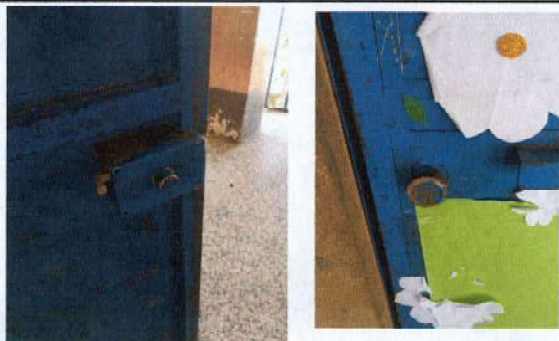
Foto 1: Las chapas de las puertas se encuentran en mal estado, se necesita sustitución
