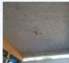
Foto 4: Los focos están dañados, se necesita sustitución
