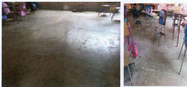
Foto 3: El piso de torta de cemento se encuentra en mal estado se necesita sustitución por piso de granito
