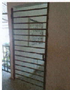
Foto 2: La puerta se ha deteriorado, se necesita cambio.
