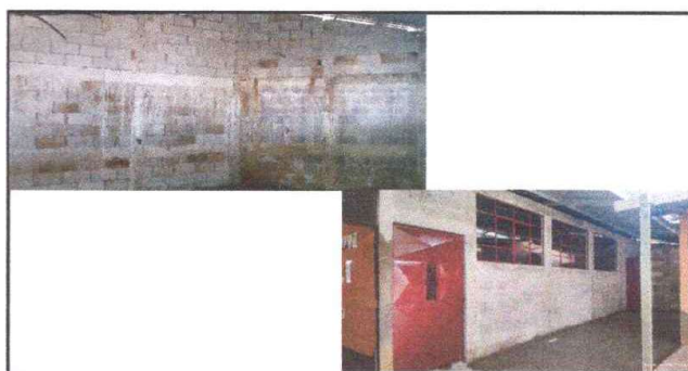
Foto 6: Paredes de módulo de aula no tiene repello
