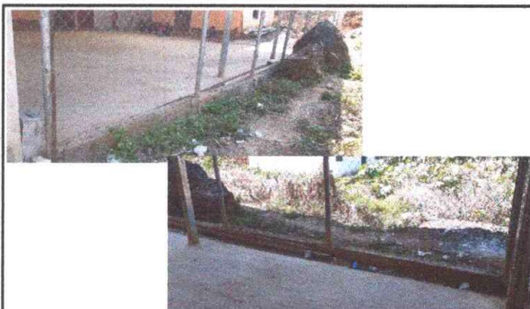
Foto 3: Se necesita mejorar el muro perimetral para mayor protección
