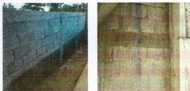
Foto 5: Paredes que necesitan repello para mayor presentación
