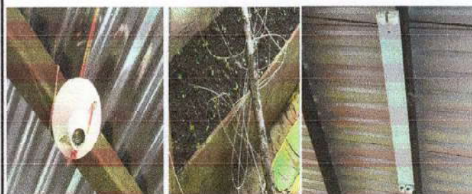
Foto 6: Plafoneras, cableado y focos en mal estado
