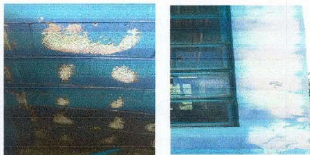
Foto 2: Paredes con la pintura desgastada
