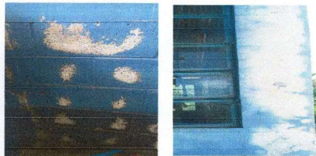
Foto 2: Paredes con la pintura desgastada
