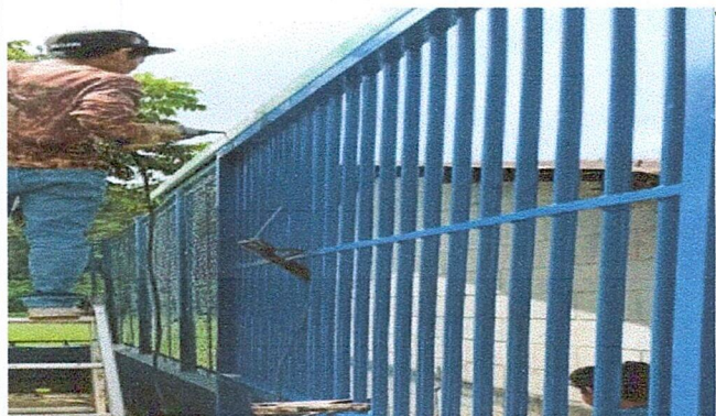
Foto 3: SUSTITUCIÓN DE PORTÓN DE METAL EN PROCESO
