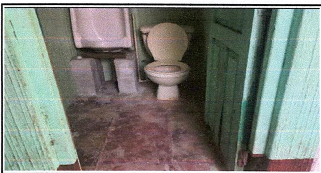
Foto 6: Sustrucción de piso en servicios sanitarios por estar en malas condiciones.
