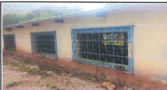
Foto 4: Mantenimiento de balcones por deterioro.
