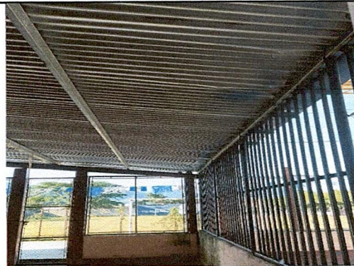
Foto 2: CUBIERTA DE LÁMINA. ÁREA 2 Y ELEMENTOS DE FIJACIÓN EN MAL ESTADO
