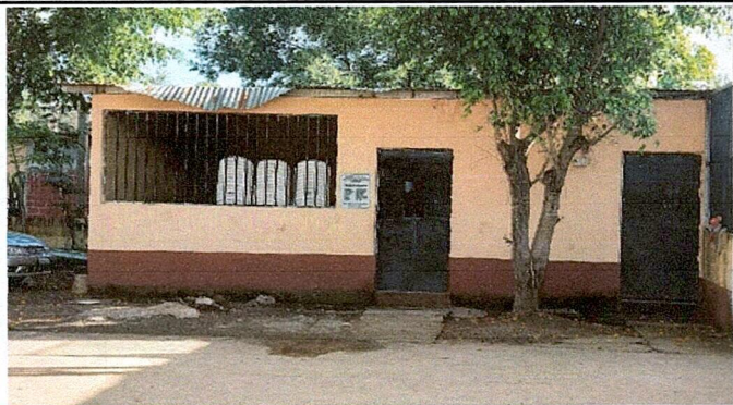
Foto1: CUBIERTA DE LÁMINA ÁREA 1 EN MAL ESTADO
