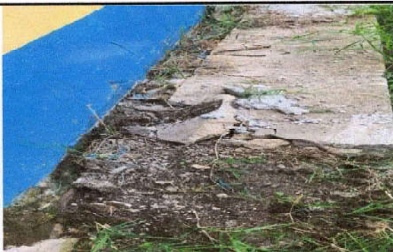
Foto 3: Banqueta de cemento en mal estado.
