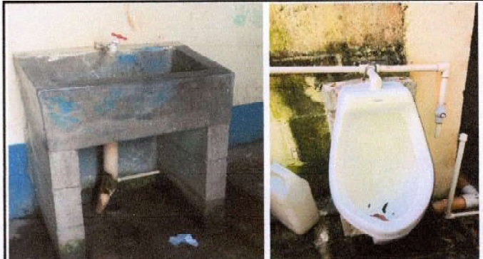
Foto 4: lavamos de cemento y mingitorios deteriorados.
