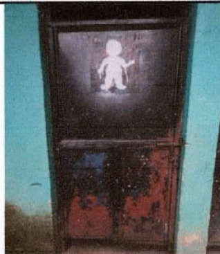
Foto 8: Puerta de servicio sanitario deteriorado y en mal estado.
