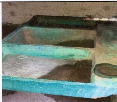
Foto 5: Pila de cemento deteriorado.
