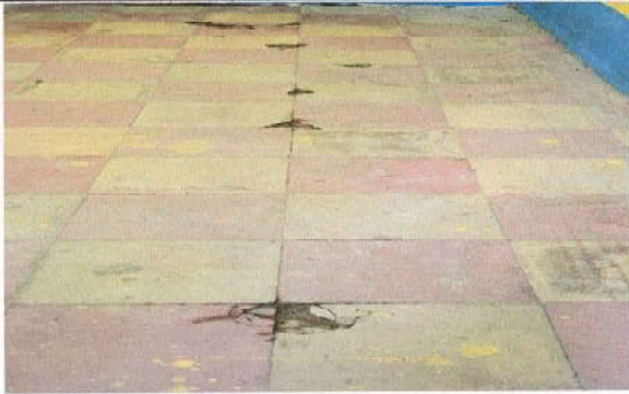
Foto1: Piso de granito en malas condiciones por antigüedad.
