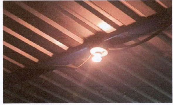
Foto 2: focos inadecuados y en mal estado para el uso en aulas.
