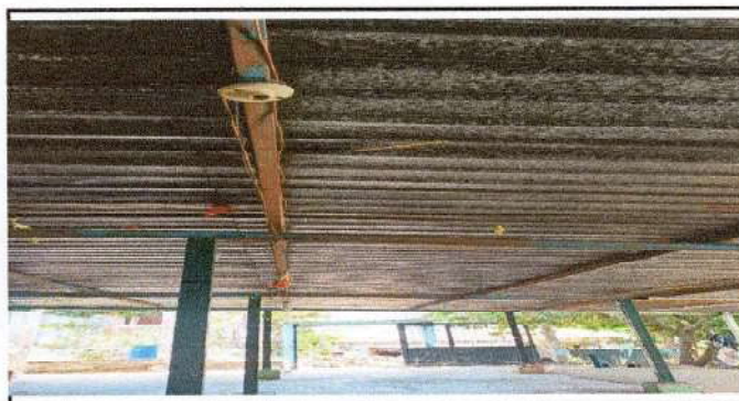
Foto 6: Lámparas del servicio eléctrico en mal estado.
