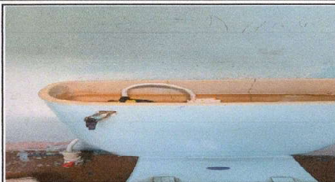
Foto 4: Sanitarios y sus accesorios en mal estado.
