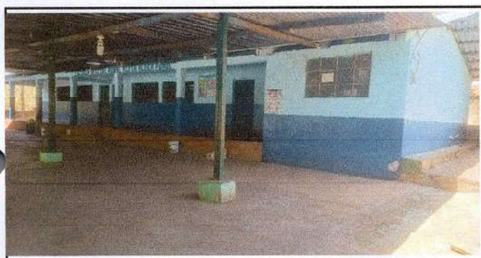
Foto 3: Pintura sobre paredes del edificio escolar deteriorada.
