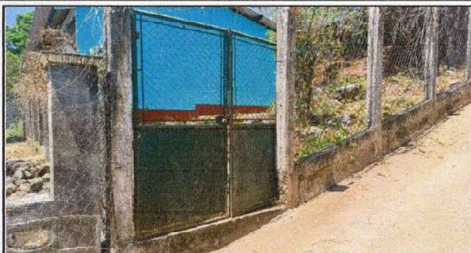
Foto1: Portón de ingreso y egreso en mal estado.
