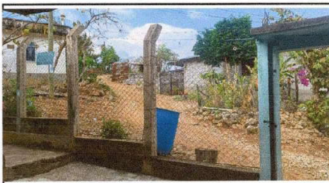
Foto 5: Malla perimetral del centro educativo en mal estado.
