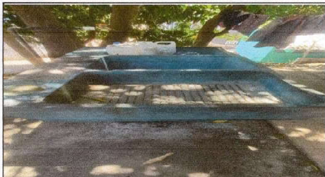
Foto7: Pila de concreto en malas condiciones.
