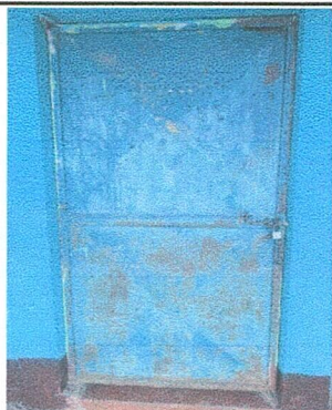
Foto1: PUERTA DE METAL EN MALAS CONDICIONES
