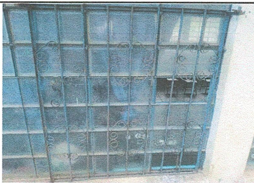
Foto 2: BALCONES DE METAL EN MAL ESTADO
