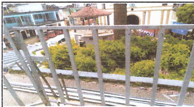
Foto 3: Baranda en mal estado.
