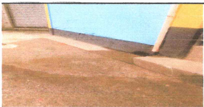
Foto 5: Red de drenajes en mal estado
