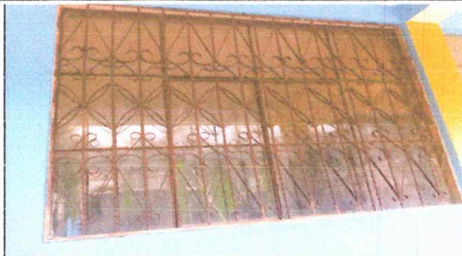
Foto 2: Balcones en mal estado.
