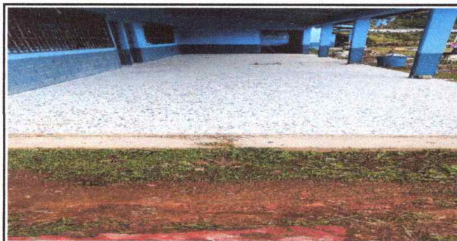
Foto 5: Piso del corredor de la escuela
