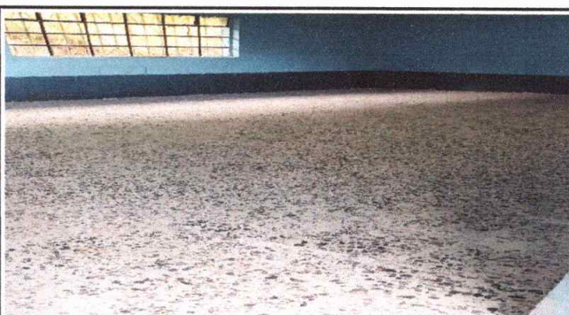
Foto 4: Piso de aulas
