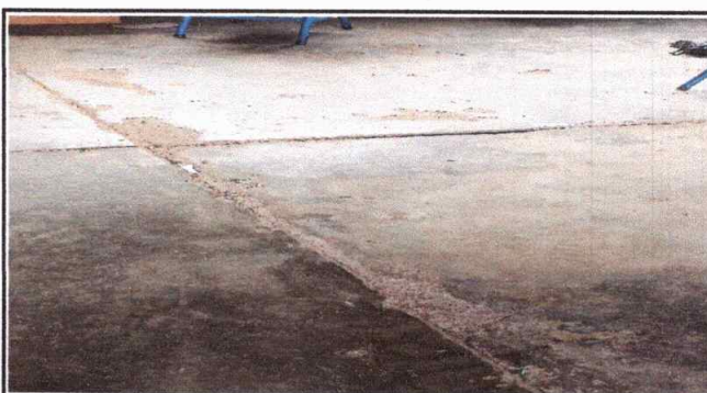
Foto 4: Piso de aulas
