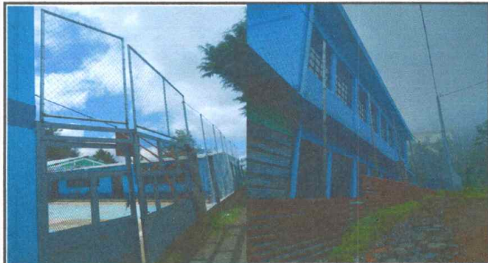
Foto 3: Malla en mal estado o cerculacion terminada
