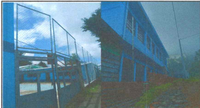
Foto 3: Malla en mal estado o cercucion terminada
