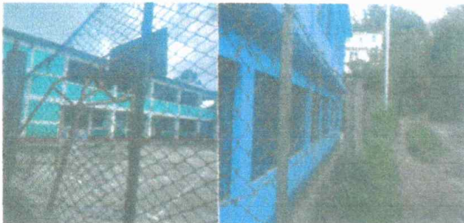
Foto 3: Malla en mal estado, lo cual será destituido
