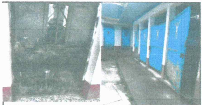
Foto 6: Puertas en mal estado de los baños. Y pintada de puerta
