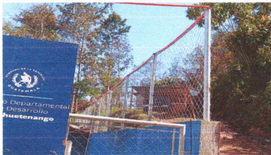
Foto 5: MURO PERIMETRAL: colocar malla para evitar accidentes
