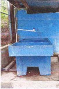
Foto 7: REPARACIÓN DE COCINA: sustituir la pila que esta en mal estado
