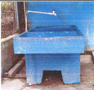
Foto7: REPARACIÓN DE COCINA: sustituir la pila que esta en mal estado
