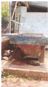
Foto 7: REPARACIÓN DE COCINA: sustituir la pila que esta en mal estado
