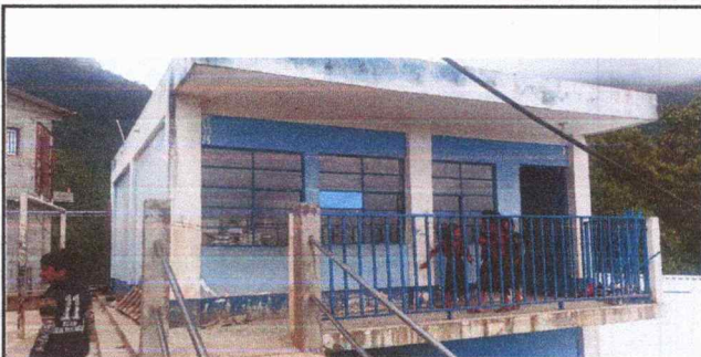
Foto 2: VENTANAS: colocar balcon a las aulas
