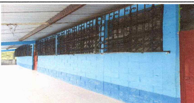
Foto 5: Sustrucción de vidrios
