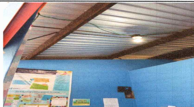
Foto 4: Sustrucción de cables, de la energía eléctrica
