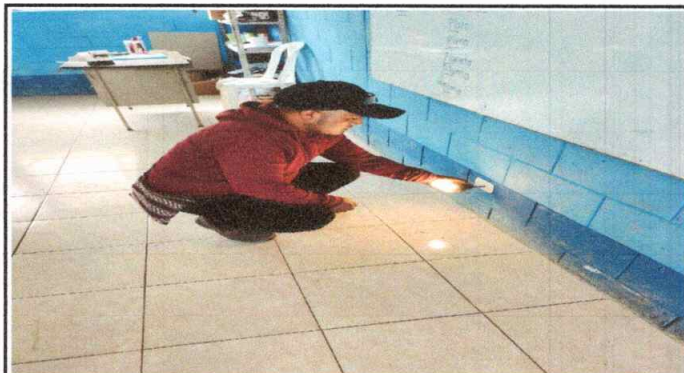
Foto 4: Sustrucción de cables, de la energía eléctrica
