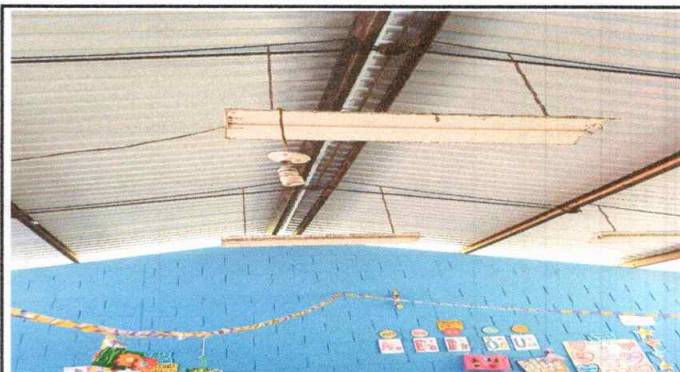
Foto 4: Sustrucción de cables, de la energía eléctrica
