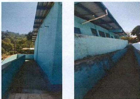
Foto 9: Pintura área peatonal estudiantes segundo nivel.
