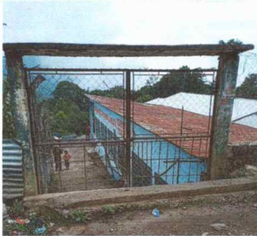
Foto 3: Portón en mal estado
