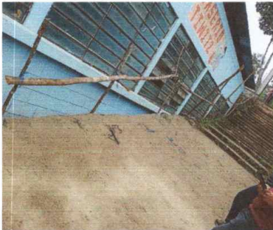
Foto 5: Baranda en mal estado que peliga la vida de los alumnos.
