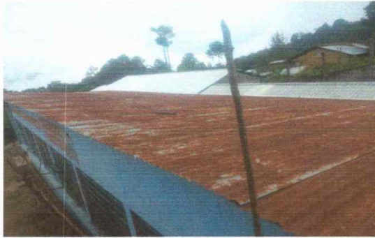
Foto 1: Cubierta de Lámina en mal estado, lo cual será sustituida
