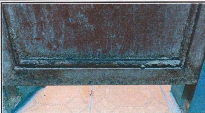
Foto 1. Puerta de Sanitario
