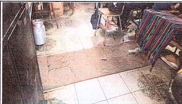
Foto 1: piso del tercer nivel en malas condiciones
