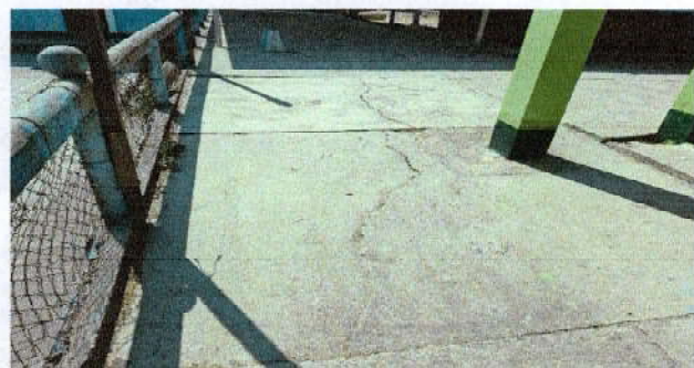
Foto 3: Reparación de piso de cemento por sufrir undimiento
