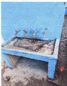
Foto 9: Chorros de lavamanos en mal estado.
