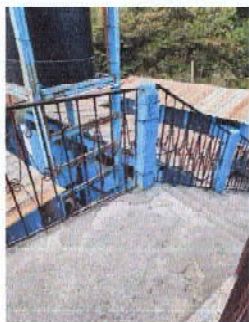
Foto 7: Baranda de metal en mal estado, partes muy deterioradas.
