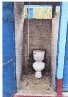
Foto 8: Paredes de servicios sanitarios sin azulejos.
