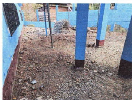
Foto 10: Patio en la parte de atrás de la escuela, en mal estado.
