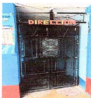
Foto No. 3 Sustrucción de puerta
