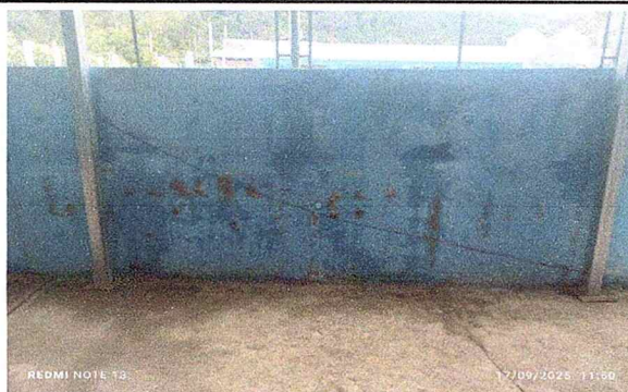
FOTO 6: Muro perimetral en mal estado
