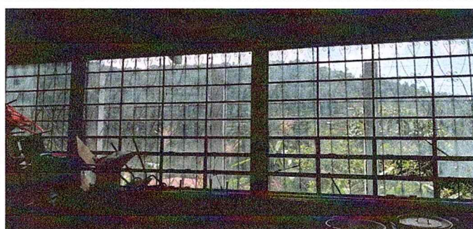
FOTO 5: ventanas en mal estado
