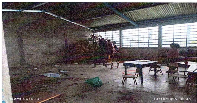
FOTO1: Cubierta de lámina de metal en mal estado
