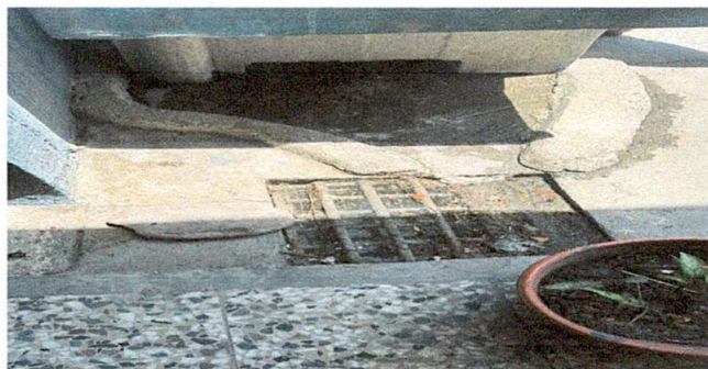
Foto 3: Sustrucción de red de drenaje
