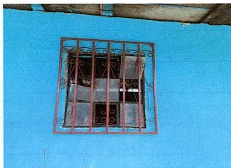
Foto 5: Sustrucción de estructura de metal de ventana
