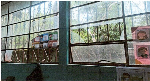
Foto 7: Sustrucción de vidrios
