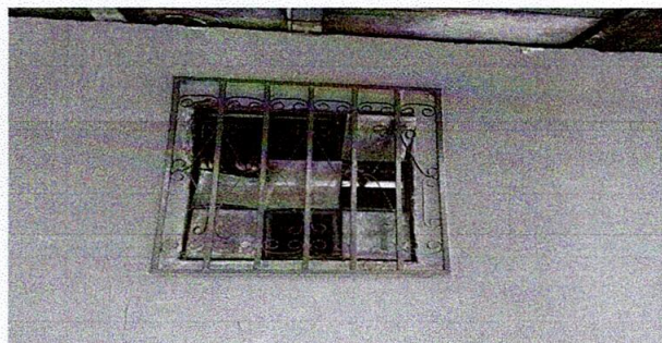
Foto 3: Sustrución de estructura de metal de ventana y sustrución de vidrio
