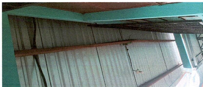
Foto 1: Sustrucción de estructura de soporte por metal
