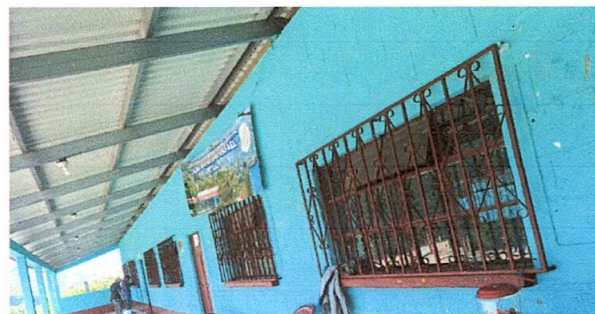
Foto 4: Sustrucción de estructura de metal de ventana
