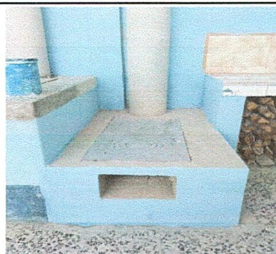
Foto 6: Mantenimiento a estufa rural
