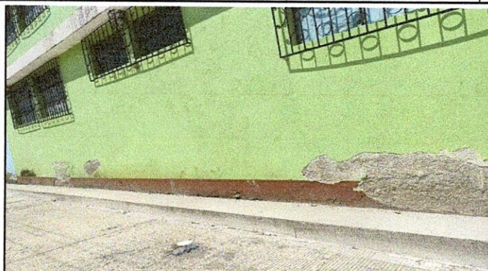
Foto 1: deterioro de pared, por lo que es importante el repello y el cernido de las mismas.
