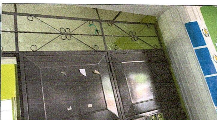
Foto 4: varios vidrios quebrados en las difentes ventanas, puertas.
