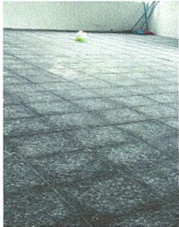
Foto 6: Piso en mal estado
